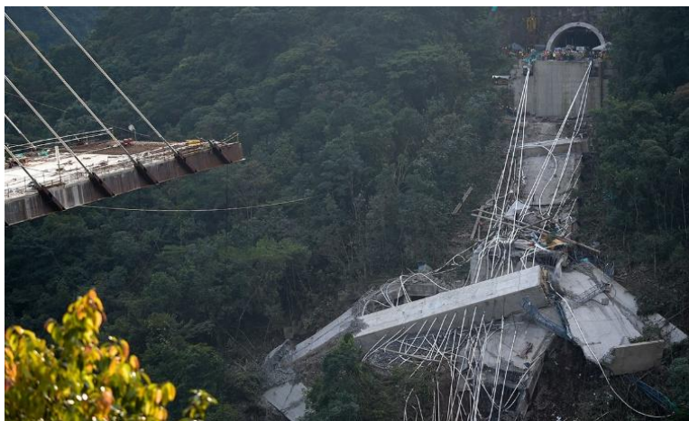
Imagen N° 1: Derrumbe del Puente Chirajara 281 .
