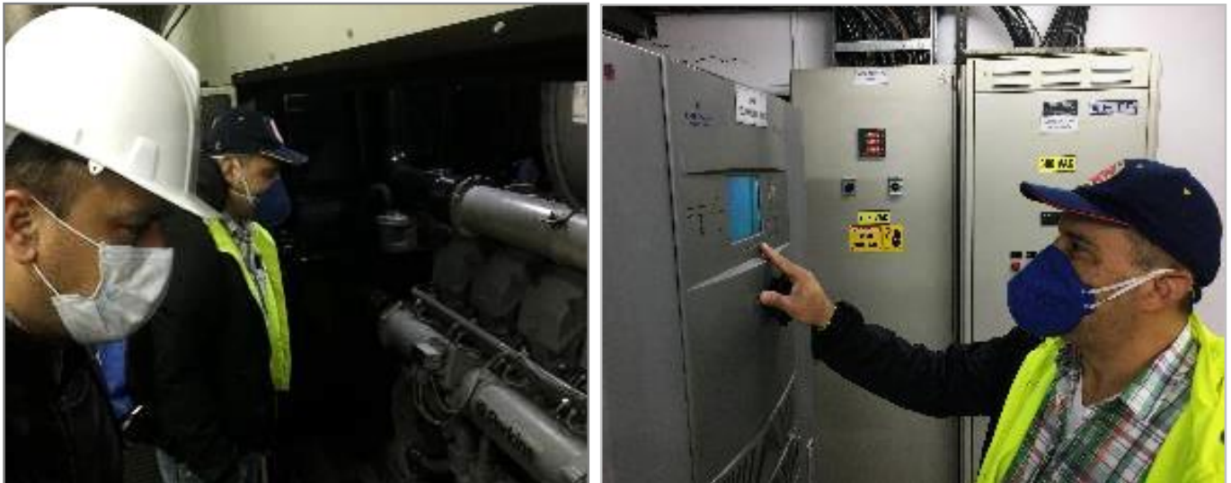
Figura 19. Supervisión a los contratos de mantenimiento de equipos especiales.
