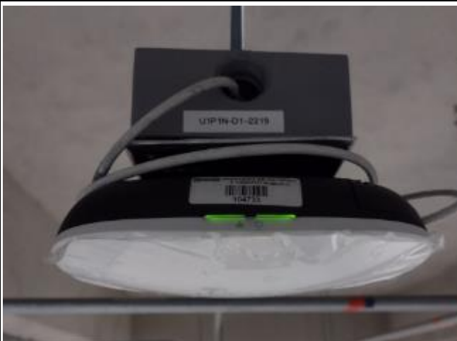
Equipo instalado y en servicio
